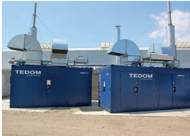
Bioplynová stanice Suchohrdly (CZ)
